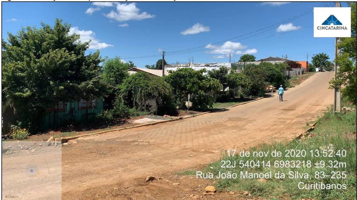
Figura 64 - Calçada sem pavimentação e delimitação na rua João Manoel da Silva
